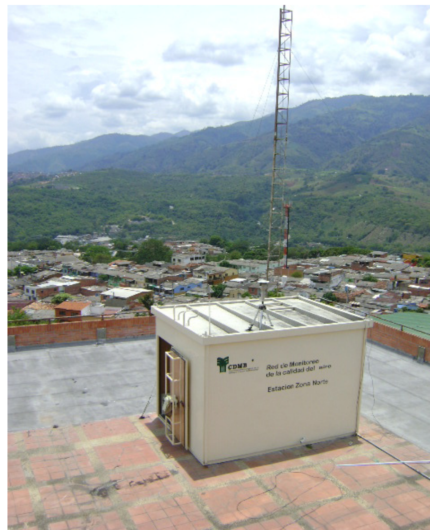
Estacion instalada en la Terraza del Hospital Local del Norte
