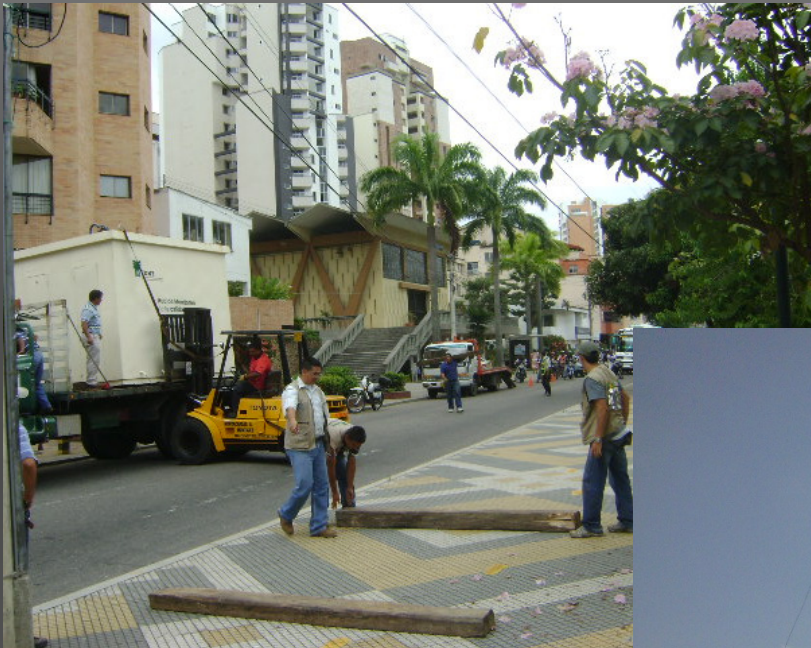
Instalación Estación de monitoreo en el parque San Pio
