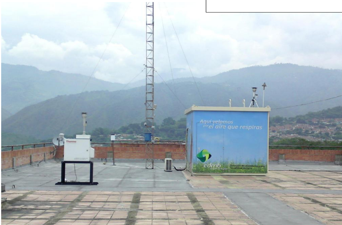
Estacion instalada en la Terraza del Hospital Local del Norte
