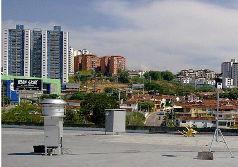
HiVol instalado en una vivienda del barrio Cañaverál
