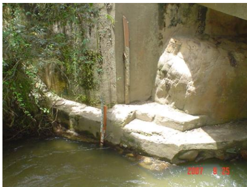
La mira esta instalada en dos secciones
