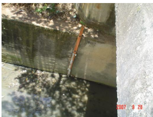
Limnimetro anclado a muro en concreto
