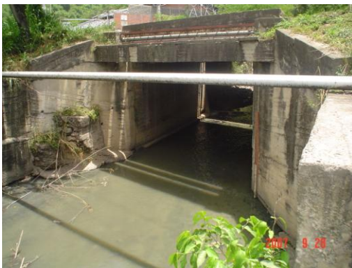
Limnómetro sobre la aleta del puente
