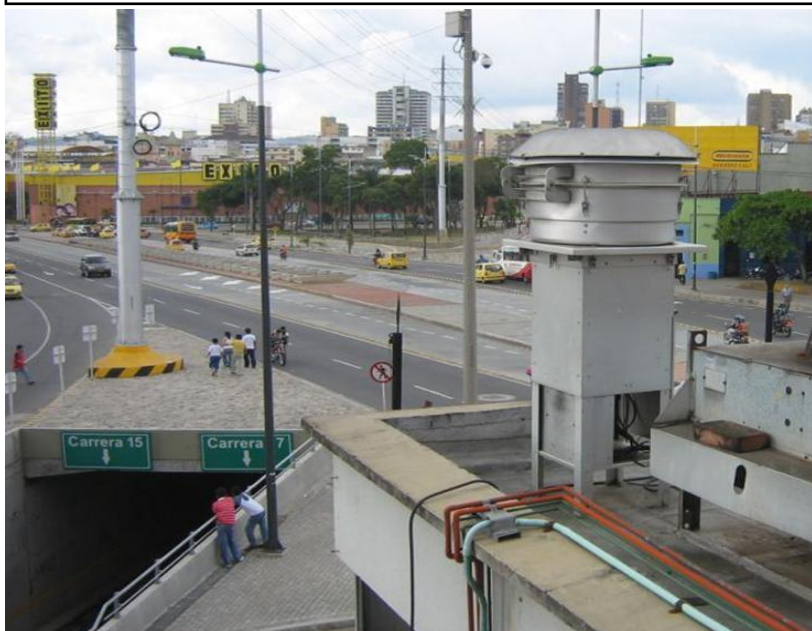
HiVol instalado en la intersección vial de la Diagonal 15 con carrera 17
