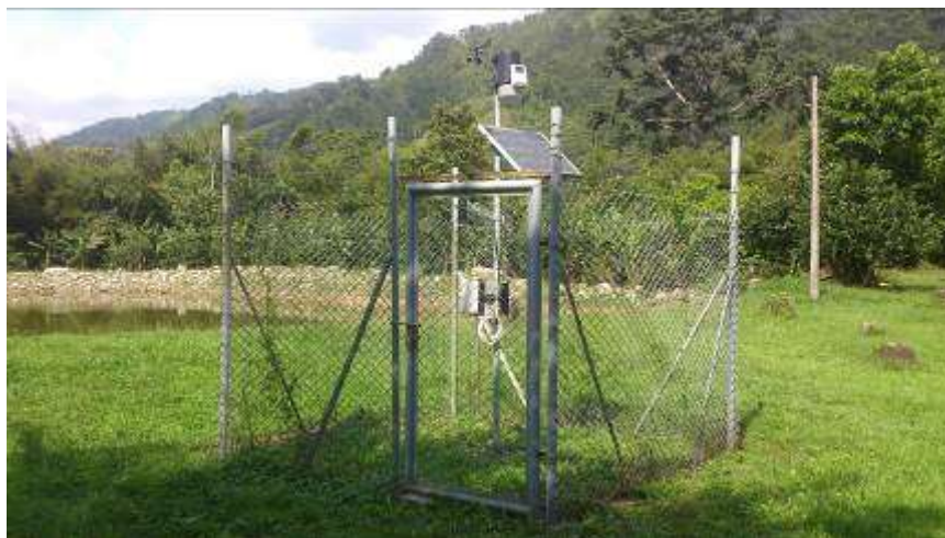
Figura 79. Instalación de sensores climatológicos
