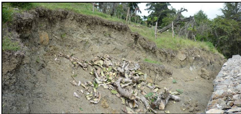
Foto 11. Deslizamiento rotacional activo en la salida al Municipio de California. Se observa en la parte superior la corona de desprendimiento.
