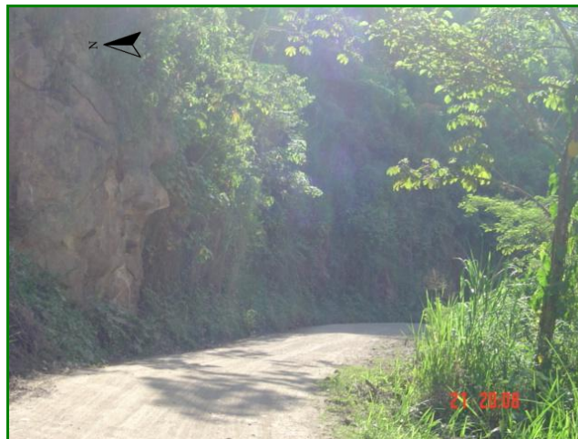
Foto 1. Se observa afloramiento rocoso de la Formación Bocas altamente fracturado, generando flujos de escombros. Vía Santa Cruz a 200m de la desviación de la carretera principal Rionegro-Playón
